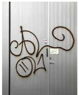
Skadegörelse – helt onödigt arbete för fastighetsskötaren att lägga tid på.
