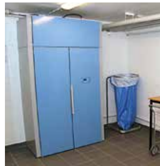
Nytt torksskåp med avfuktare.
