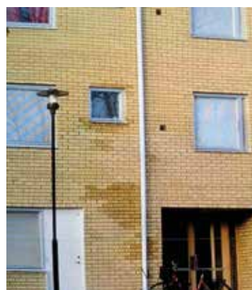
När vattenläckan tränger igenom väggen ut i fasaden så har det gått långt och kräver ett stort arbete.
