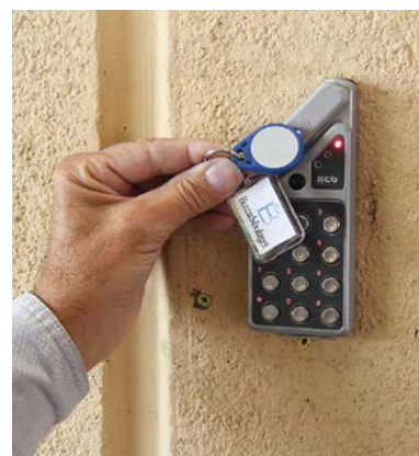
Låssystem med taggar ökar säkerhet och trygghet i gemensamma utrymmen såsom källarförråd, tvättstuga och soprum.
